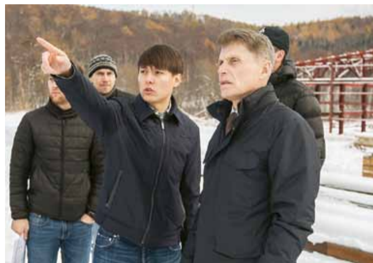
Губернатор Сахалинской области Олег КОЖЕМЯКО и Александр КАН на площадке строительства спортивного комплекса «Восток»
