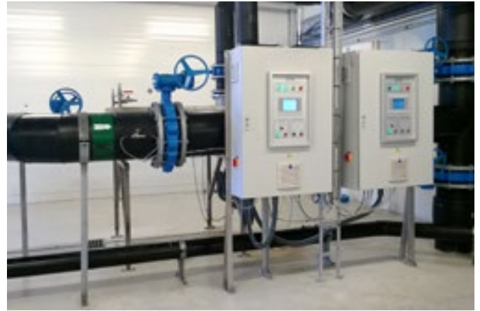
УФ-установки производительностью 450 куб. м в час для обеззараживания морской воды (Норвегия)
