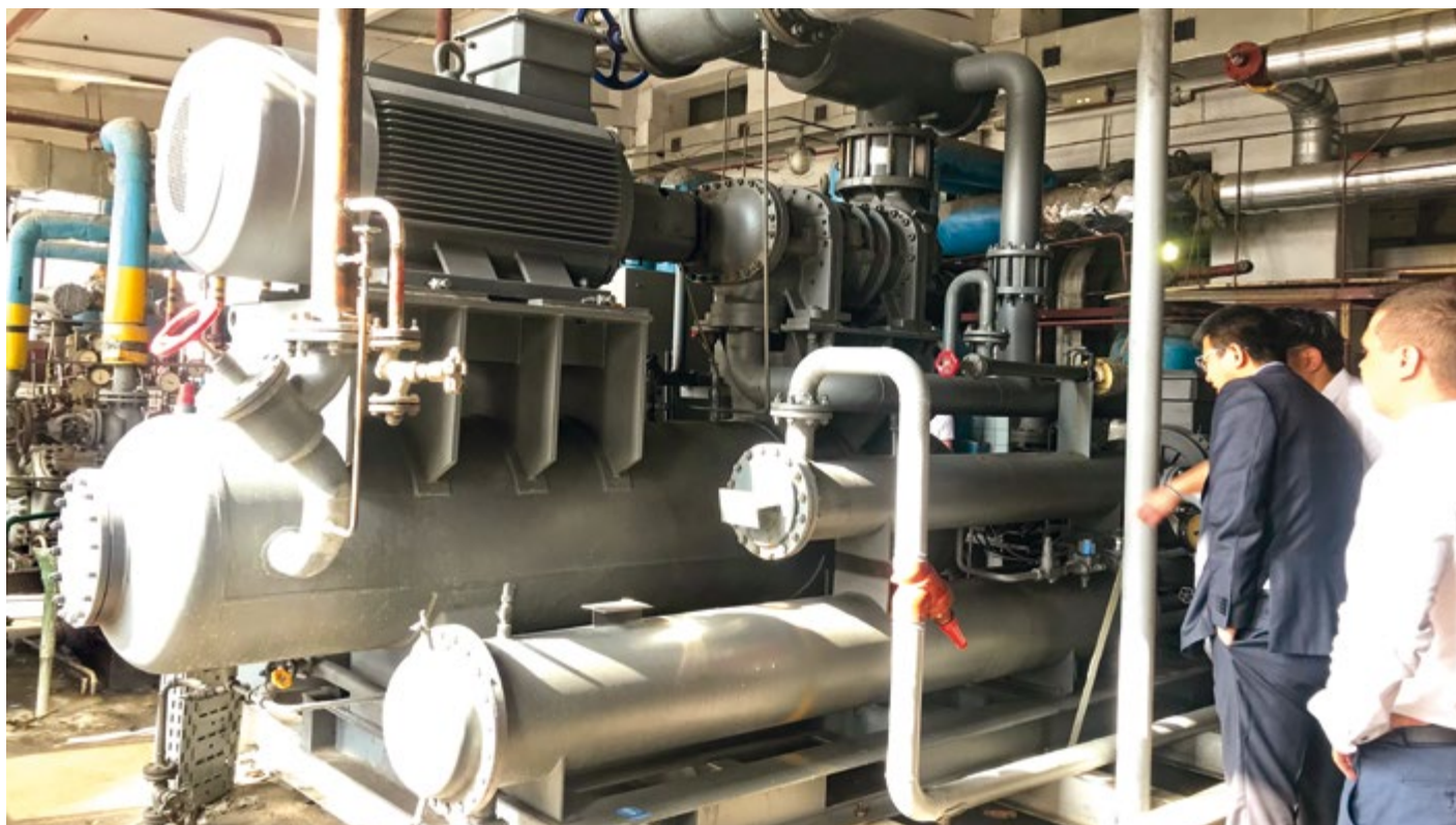
Новый двухступенчатый компрессорный агрегат на Новосибирском хладокомбинате
