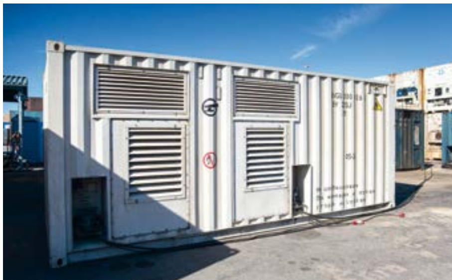
Один энергоконтейнер обеспечивает питание 16 рефконтейнеров в течение трех недель
