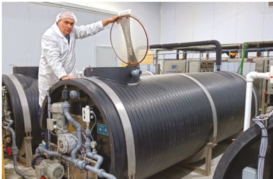
Компрессоры охлаждают воду до температуры -1... -1,5°C, она превращается в шугу и по трубам поступает вниз, в бункера. Это очень дорогое оборудование, но именно жидкий лед помогает сохранять уловы свежими до обработки и в итоге выпускать товары, которыми компания по праву гордится
