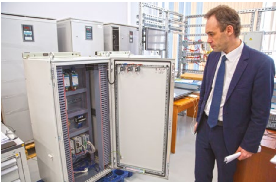
Электрораспределительное оборудование — одно из профильных направлений концерна
