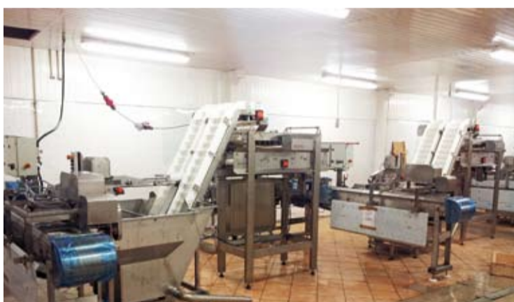
Машина автоматической загрузки рыбы в оборудование ARENCO VMK SEAC
